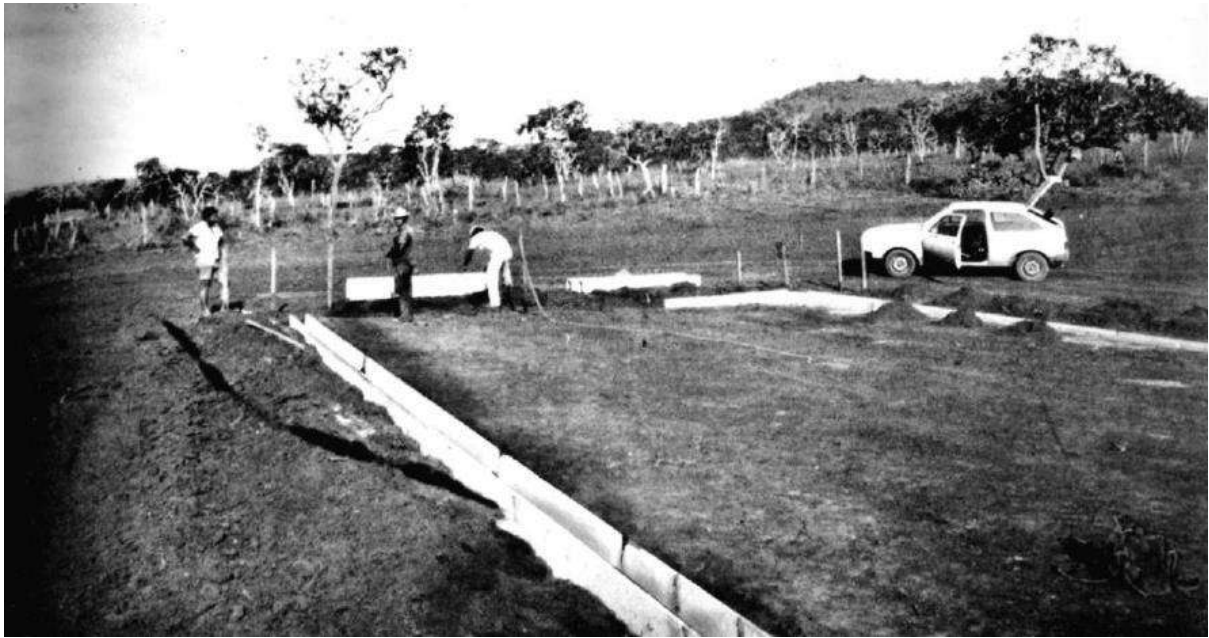
Instalação das calhas de drenagem sobre colchão de areia. Definindo o gabarito para instalação na sequência das próximas peças. Fonte: LIMA, 1984, p. 45.
